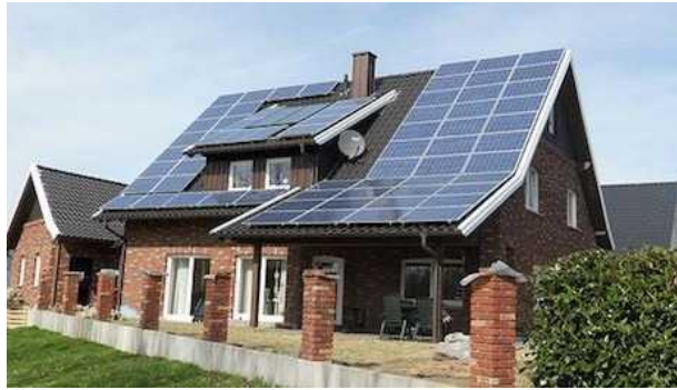
주택 태양광 예시
