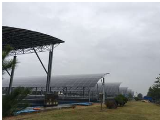
[그림 80] 노온정수장-큐원솔라(주) 태양광발전설비
