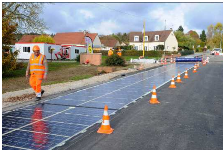
프랑스 노르망디 도로 태양광 발전소
