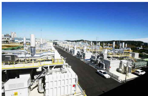
경기그린에너지 연료전지발전소 전경
