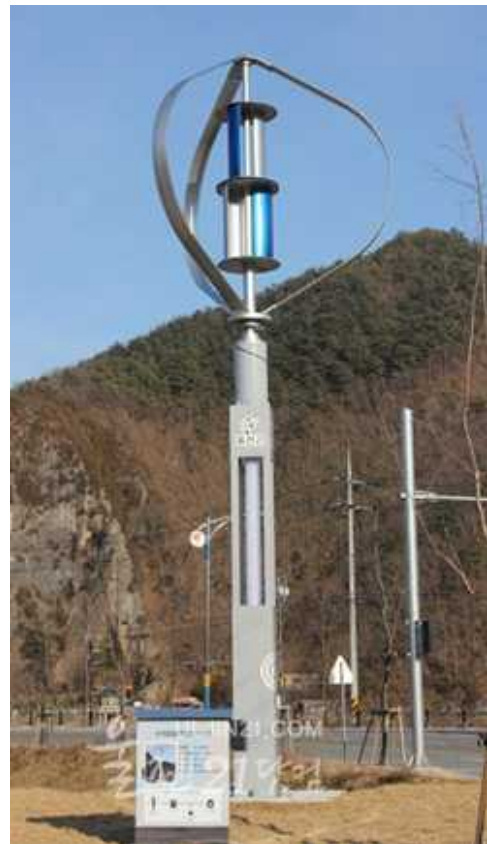
울진종합운동장에 설치된 3kW급 소형풍력 발전기
